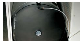
Depósito de acumulación de alta capacidad.
