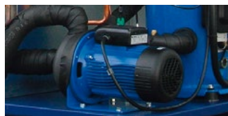
Pompe P3 (3 barg) e P5 (5 barg), opzionali.
